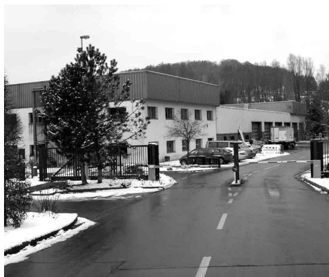
Das renovierungsbedürftige Dach des technischen Dienstes wird nächstes Jahr ausgebessert.
